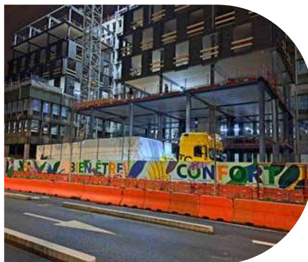
Livraison de matériaux de nuit sur un chantier de la Part-Dieu - Lyon 3 e
